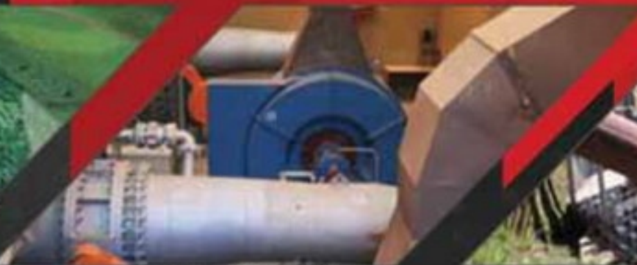
Instalação elétrica de geração
